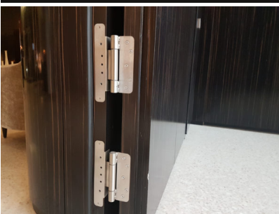
Bildtext 2: Das Rollenbandsystem für schwere Objekttüren „Objecta“ im Einsatz in der Fahrstuhllobby des Grandhotel „The Fontenay“ in Hamburg. Die riesigen Türblätter mit Aufdopplung stehen 180 Grad geöffnet und schließen im Brandfall automatisch. Foto: BaSys
