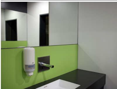
Bildtext 2: An der KGS Neustadt schuf Peglow Design Lernumgebungen, die helfen, die Ziele der Schule umzusetzen. Auch der oft vernachlässigte Sanitärbereich gehört für Peglow dazu. Hier erfüllt das „Homapal Aquaris Spasystem“ umfassende Anforderungen an Design, Funktion und Wirtschaftlichkeit. Foto: Homapal
